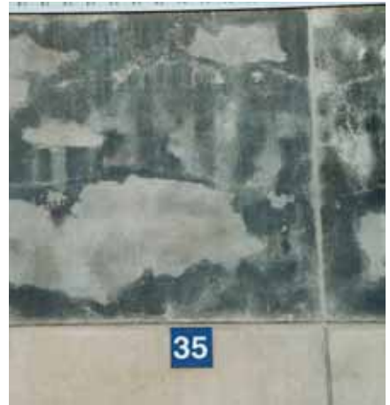
Taches très marquées au niveau du quai 35
